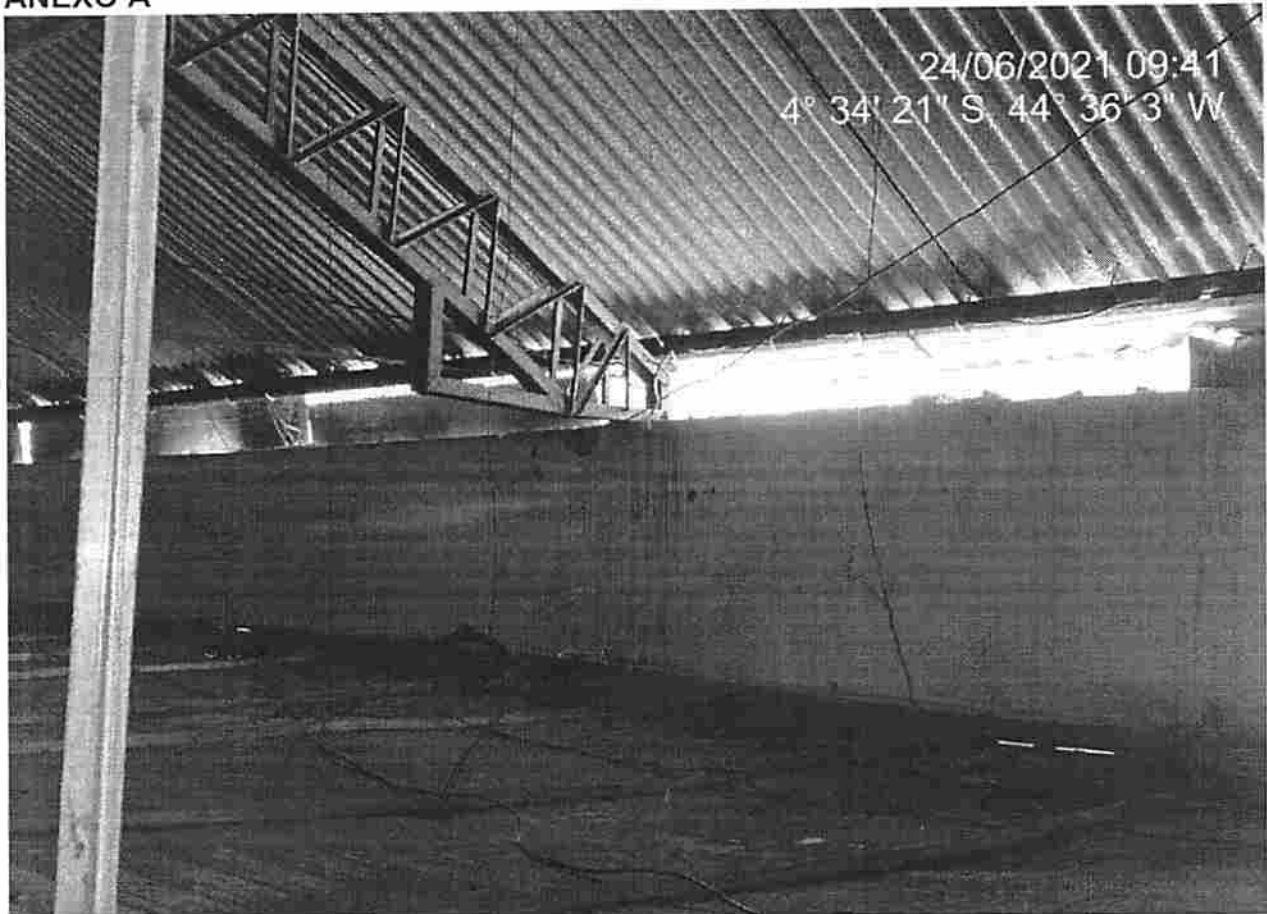
Telhado com vazamentos
