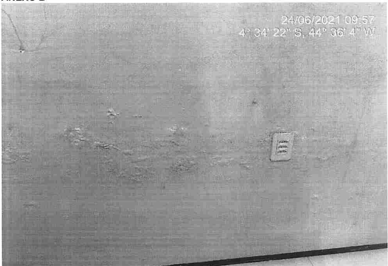
Paredes com infiltração
